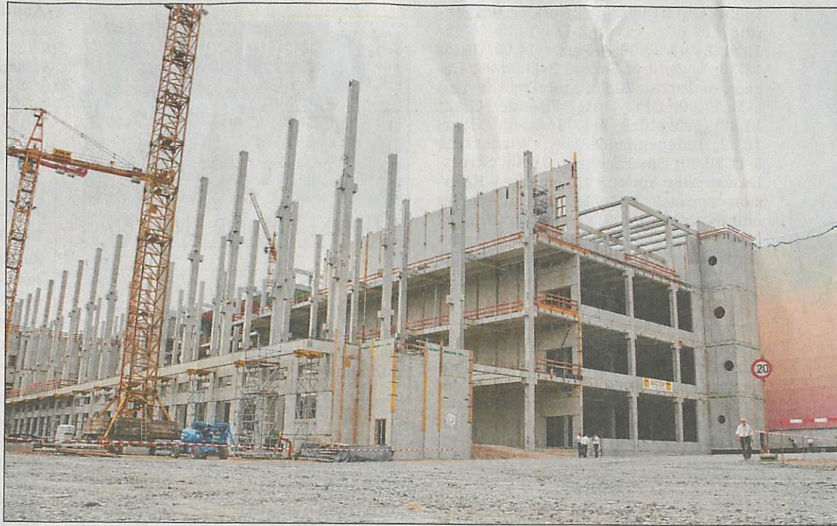
DER ROHBAU STEHT: Gestern feierte der Pforzheimer Versandhändler Bader Richtfest in Östringen. In Betrieb gehen soll das moderne Logistikzentrum mit Hochregallager im November 2017. Foto: cz
